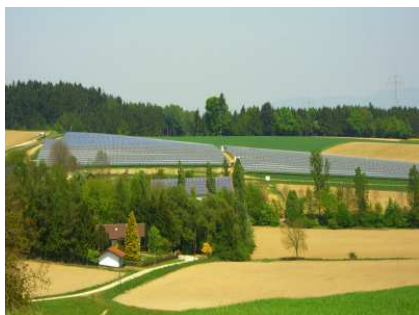
Photovoltaikanlage Oberhörbach 1.7 MWp
